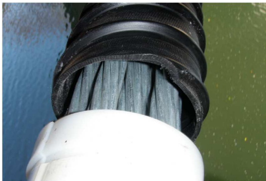
写真-11 PC鋼材
